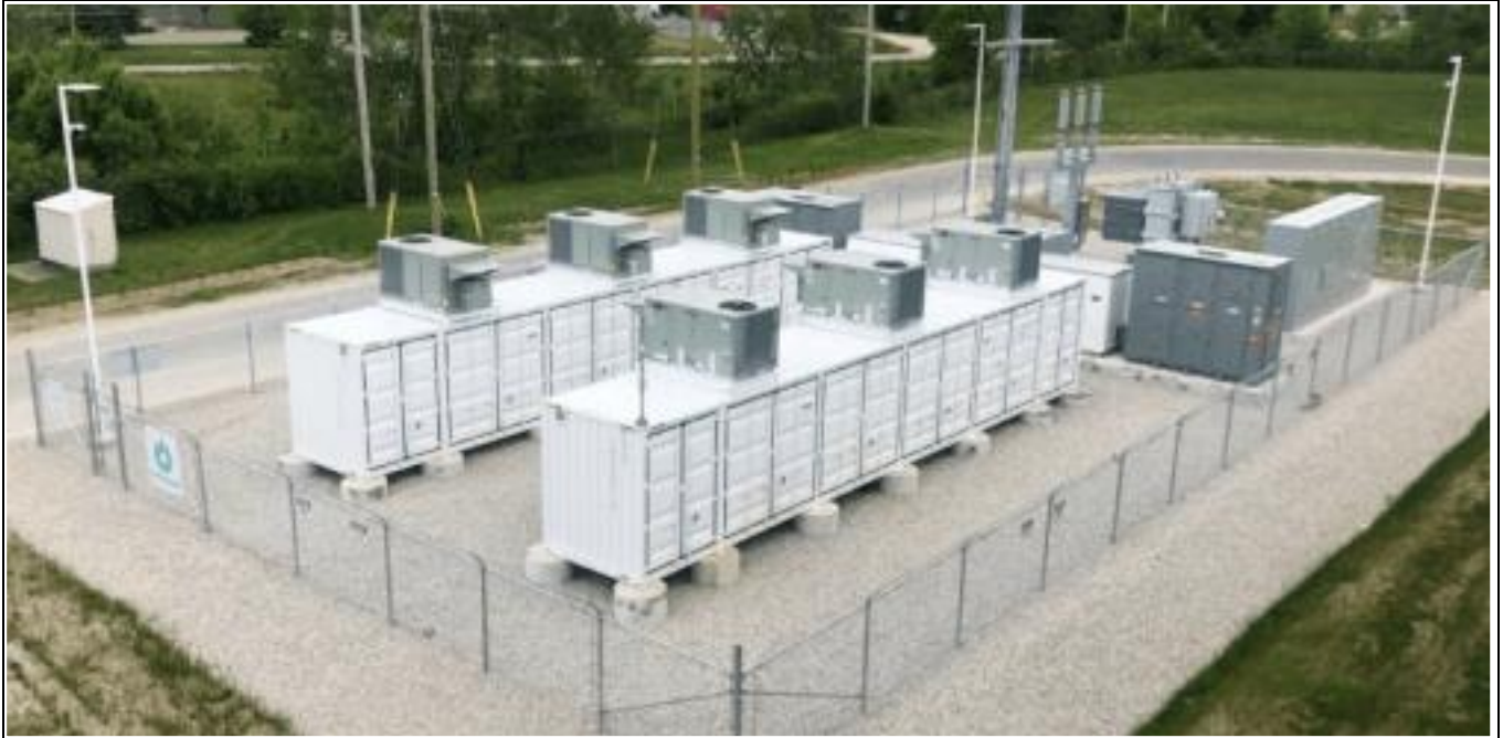
Рисунок 9 – Приклад вигляду установки збереження енергії
